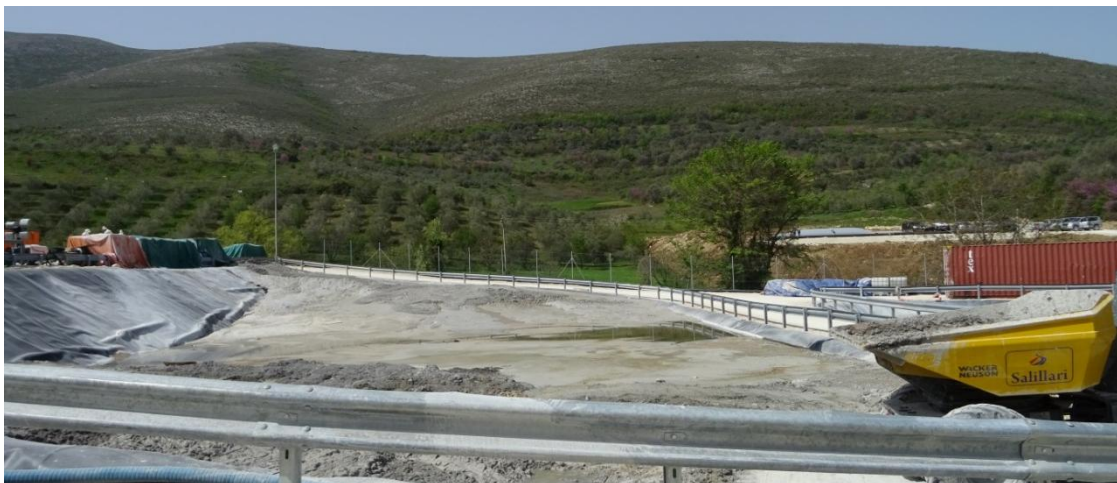
Figura 26: Gropa e mbetjeve e veshur me membrane për depozitimin e mbetjeve të shpimit me bazë uji në sheshin e shpimit (Shpirag-4).
